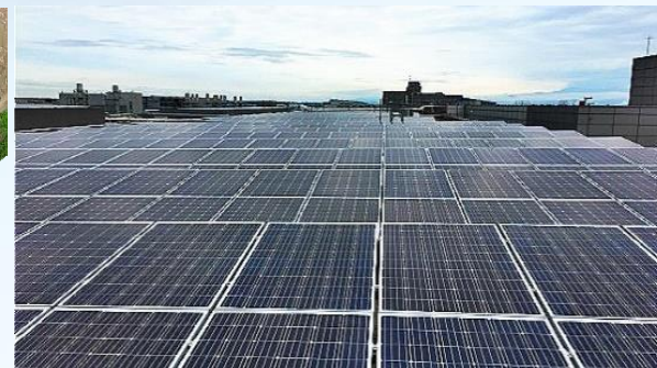
中美晶 中科矽品 2,802.5kWp
