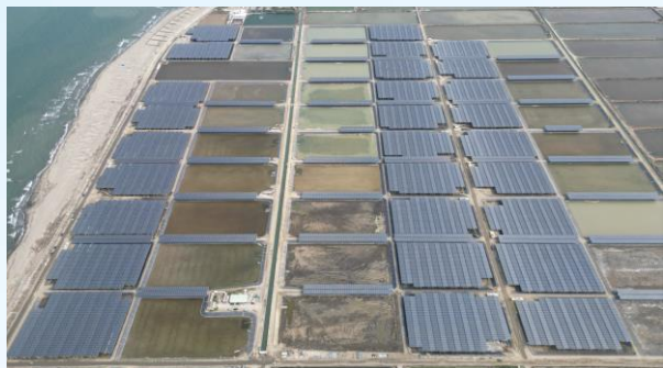
北門漁電共生 40,080kWp
