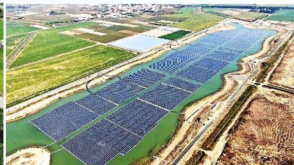
嘉義滯洪池 19,500kWp
