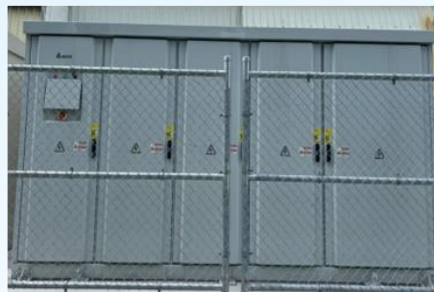
富立金實業 2.5MW
